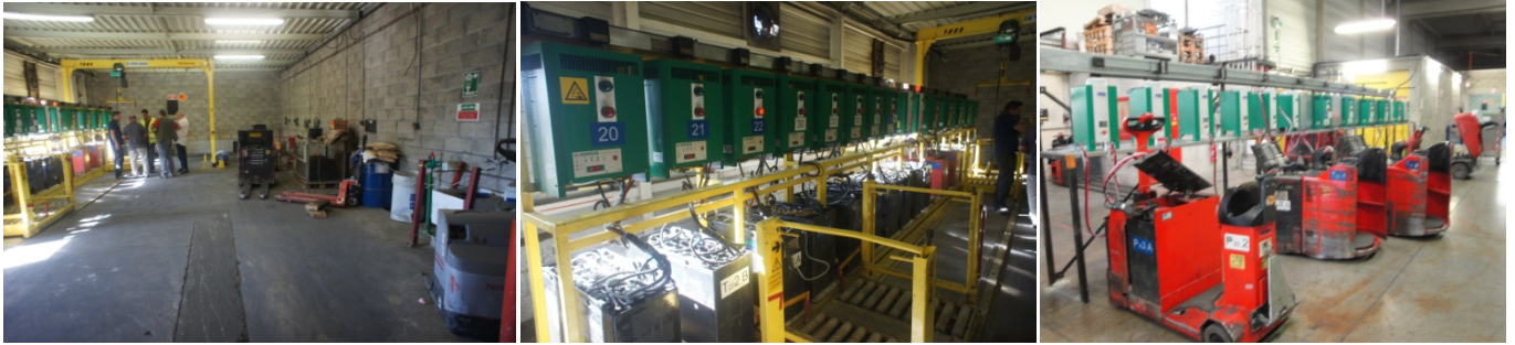
Local avant démontage, installation provisoire à l'extérieur de la salle de charge
